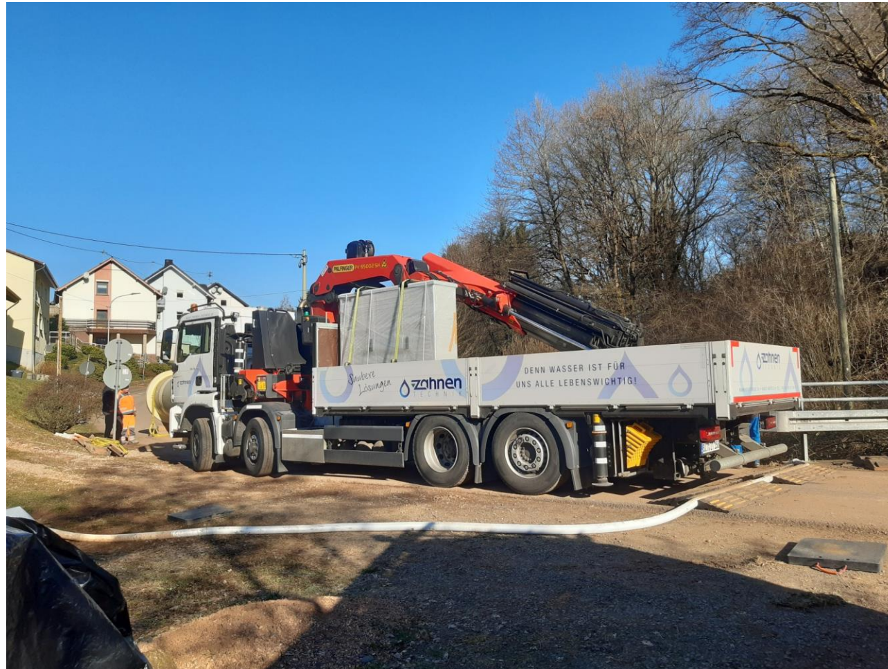
Aufstellung einer neuen Schaltanlage mit Cloud-Anbindung
